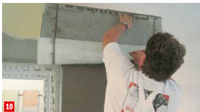
10 Do vrstvy lepiacej stierky sa vkladá sklotextilná mriežka. Jednotlivé kusy sklotextilnej mriežky sa spájajú s presahom min. 10 cm.
